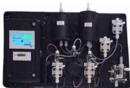
Generador con sistema de medición integrado y dos bombas externas
