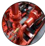
Detalle de bomba eléctrica.
