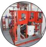
Equipo Contra Incendios
