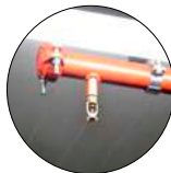
Detalle de rociador.
