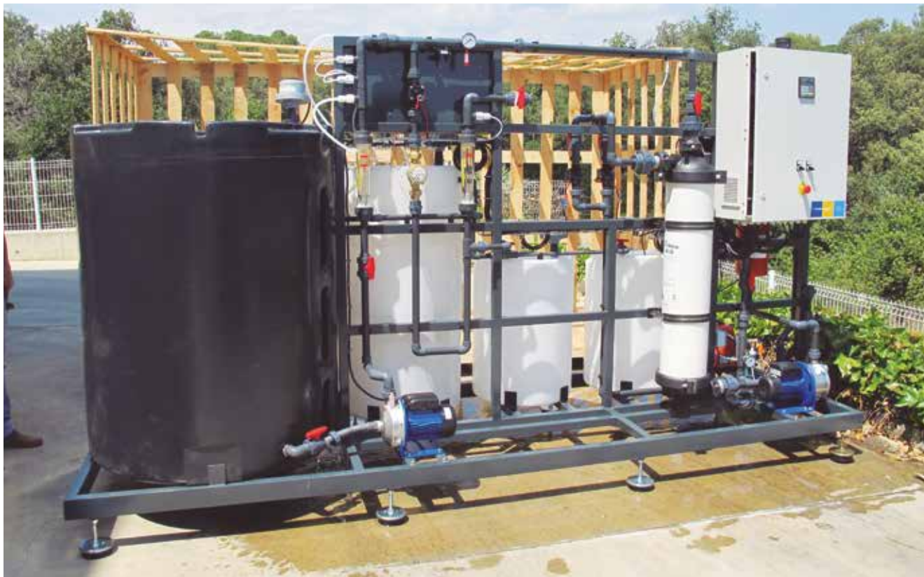
Planta de ultrafiltración de 4m 3 /h para la potabilización de agua de bebida, instalada en Uganda.
