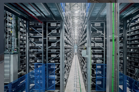
ALMACÉN AUTOMATIZADO AUTOMATIC WAREHOUSE
