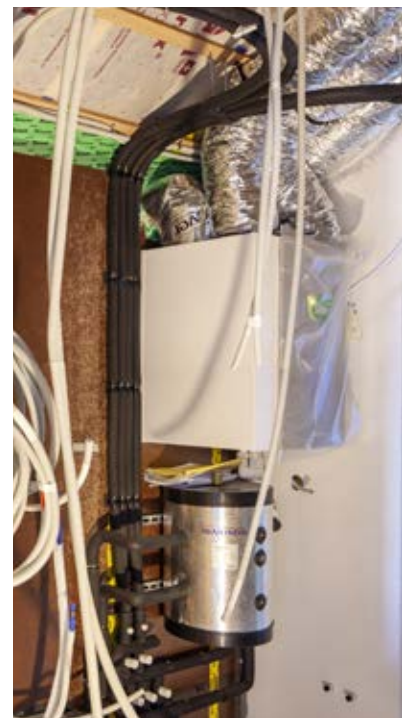
Sistema de Ventilación de la vivienda
