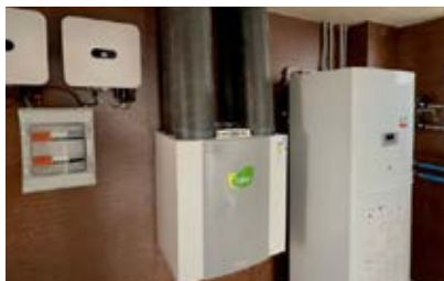
Sistema de Ventilación de la vivienda
